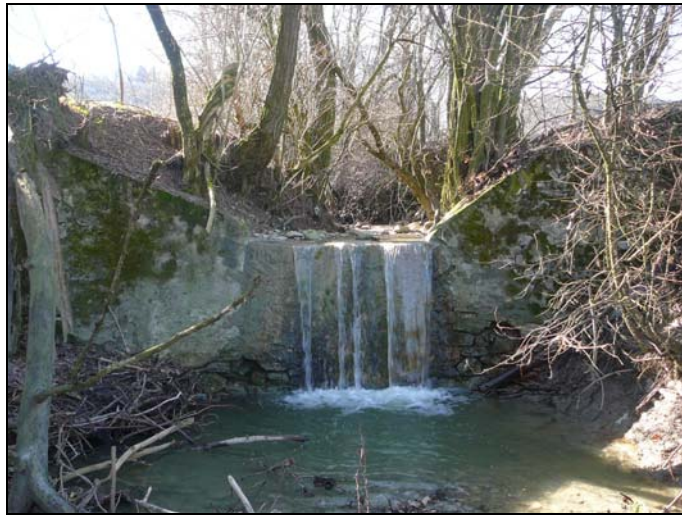
Fig. 77 Enzola: esempio di briglia esistente da riproporre lungo tutto il tratto montano
