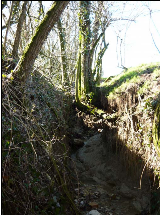
Fig. 81 Formica ovest: erosione lungo la sezione di deflusso
